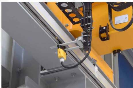
Fot.1. Odbierak prądowy w linii szynoprzewodowej.
