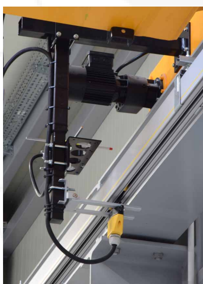
Fot.3. Linia szynoprzewodowa UNILIFT-UCR - widok 2.
