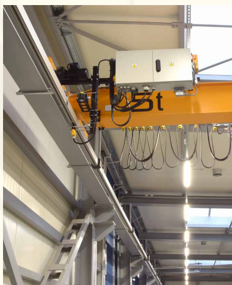
Fot.2. Linia szynoprzewodowa UNILIFT-UCR - widok 1.
